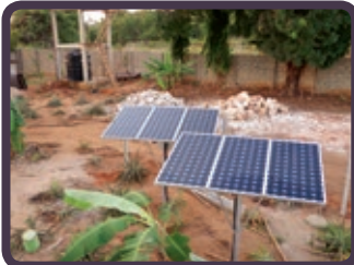
Solarbrunnen mit Wasserturm
